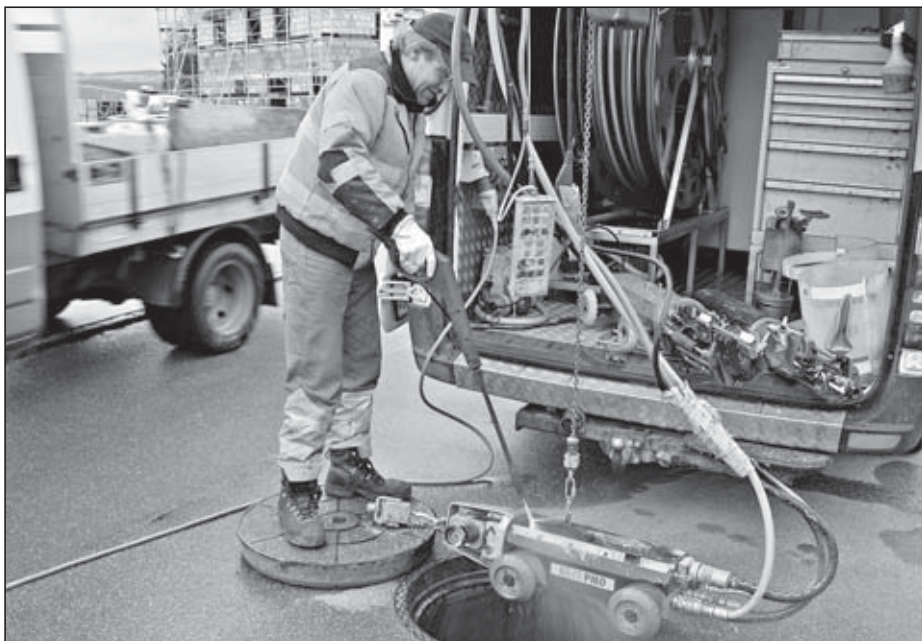
Der Kanalisations-Roboter muss nach getaner Arbeit gereinigt und gewartet werden.
