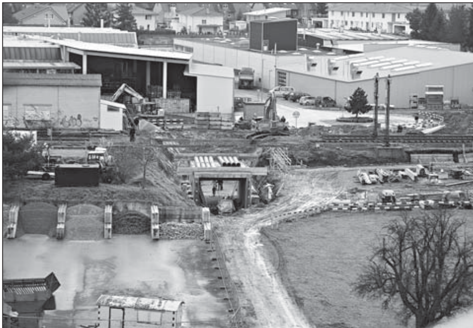
Die Unterführung im Langfeld wird an zwei Tagen an den Bestimmungsort eingeschoben. tm.-
