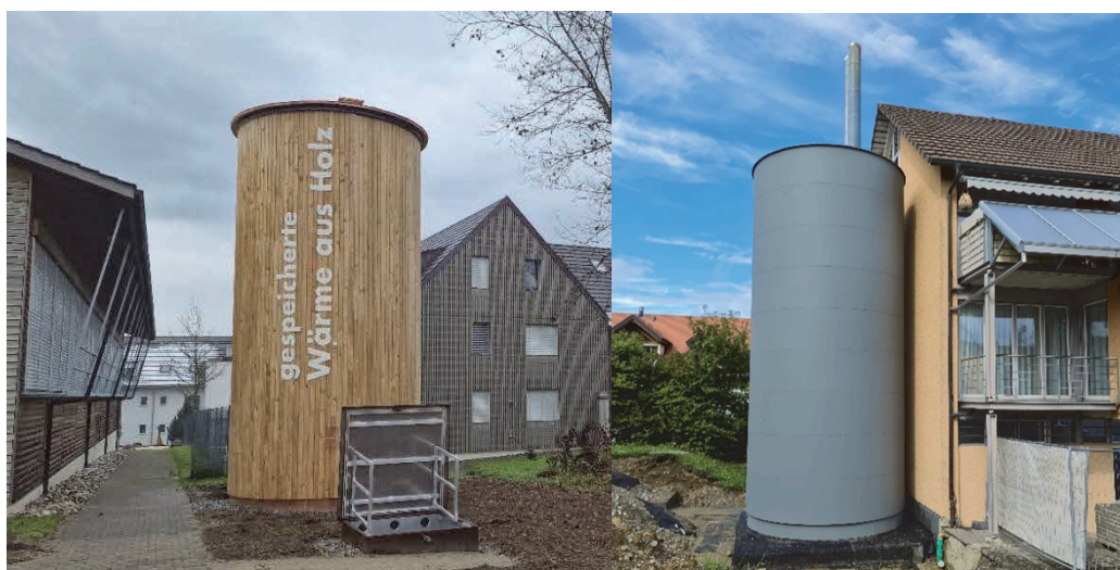
Grosser Energiespeicher, welcher bei Variante Wärmepumpe oder Sanierung am bestehenden Standort zwingend realisiert werden müsste (links Beispiel WV Stammheim, rechts Beispiel WV Kaltenbach)
