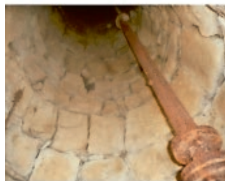
Wasserschacht mit Pumpenrohr
